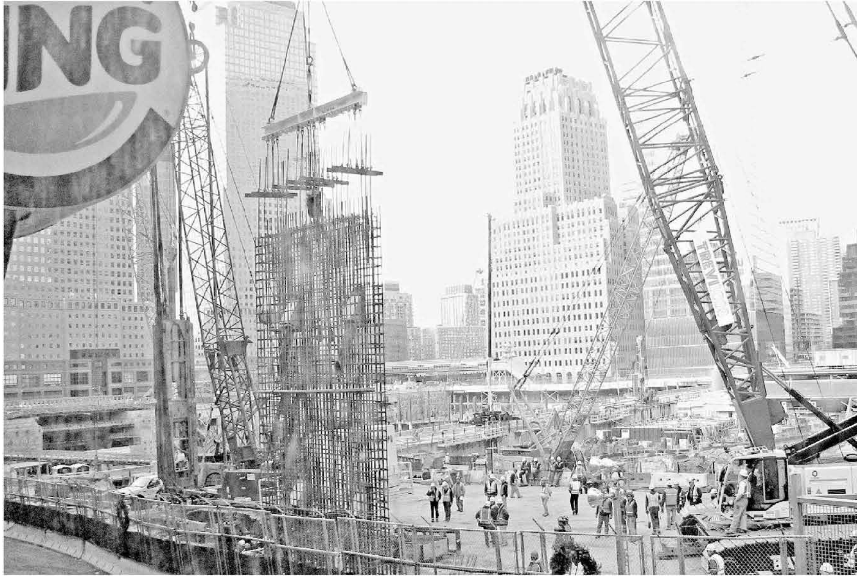
Am Ground Zero in New York baute das italienische Familienunternehmen Trevi das Fundament.
